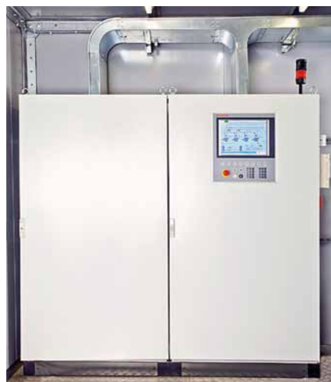
Основной шкаф управления котельной UNI
